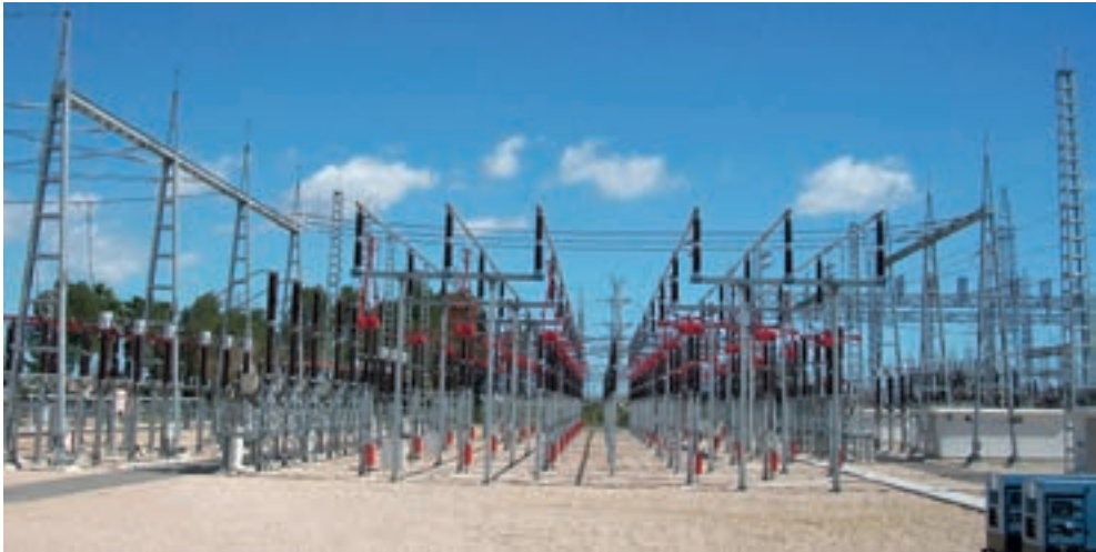
Detalle de la subestación Bernat de Alzira.
