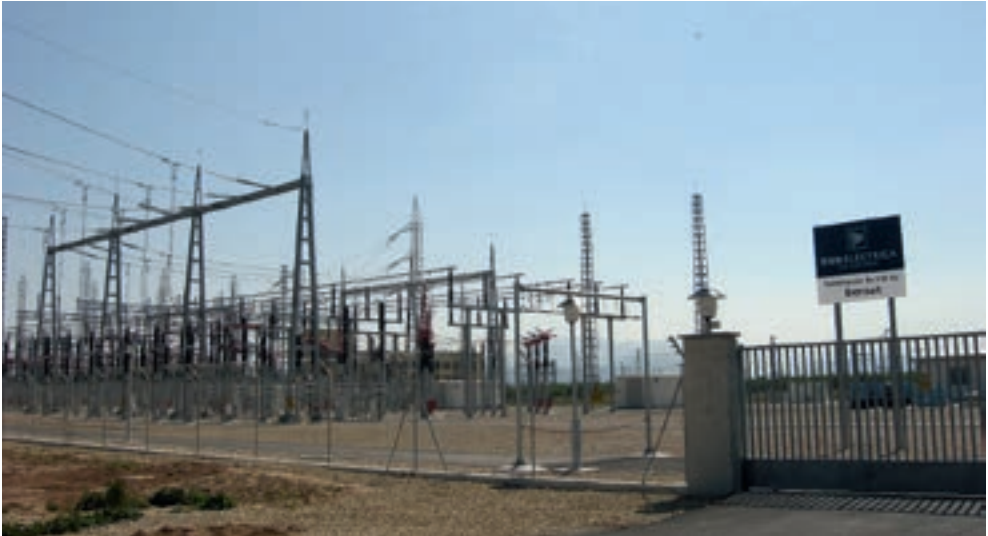
Entrada de la subestación Bernat de Alzira.
