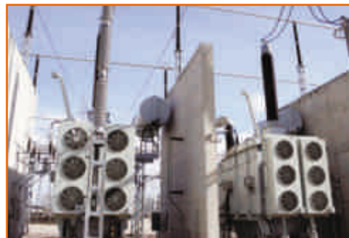
Sistema de refrigeración de un transformador de potencia.
